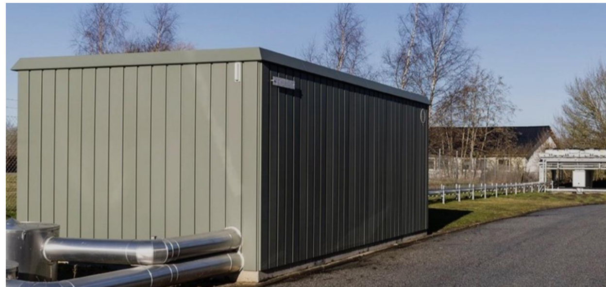
Eksempel på luft-vand varmepumpe. Ventilatorerne står i baggrunden.
